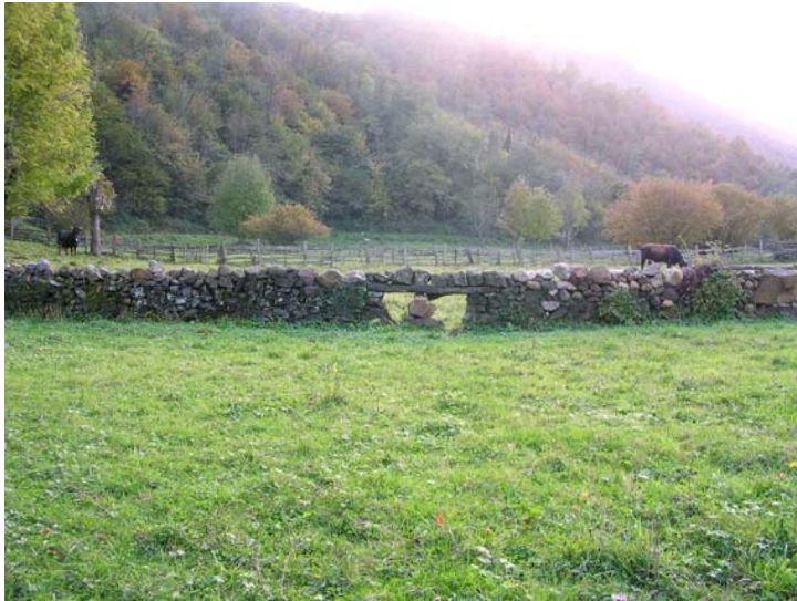
Figura 31. Drenaje instalado en un muro dentro de las vegas del río Aller.
