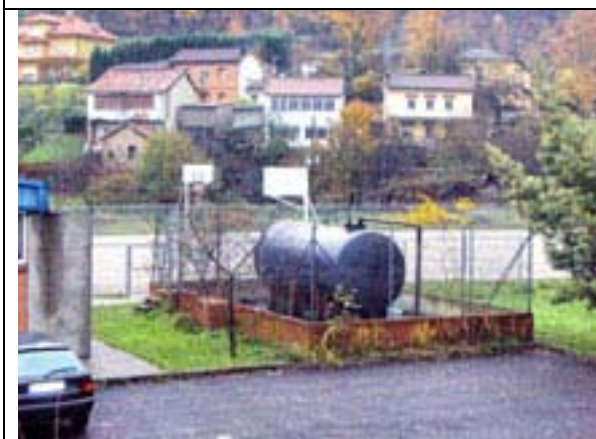
242 Depósitos de combustible y similares vinculados a la vivienda
