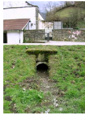
Drenaje de salida
