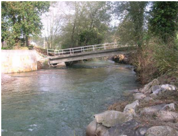
Figura 29. Socavación local en el puente de San Timoteo durante la avenida de 2003 (Río Negro, Luarca).
