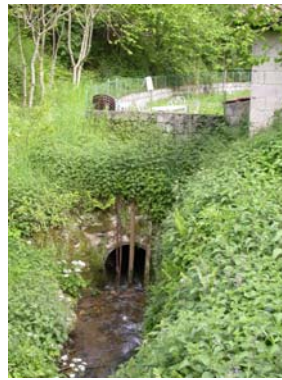
Drenaje de entrada
